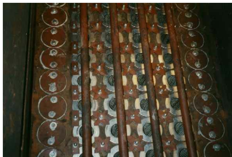
Bild 8: Reingasraum mit eingebauten Filterpatronen
