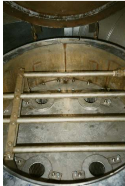
Bild 4: Blick in den Reingasraum
